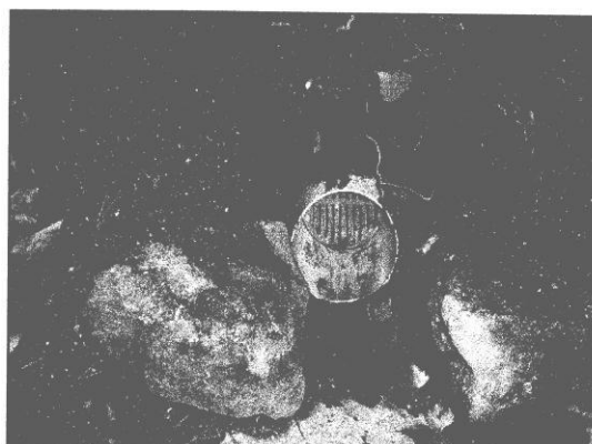
Trop-plein à "grille basculante"
